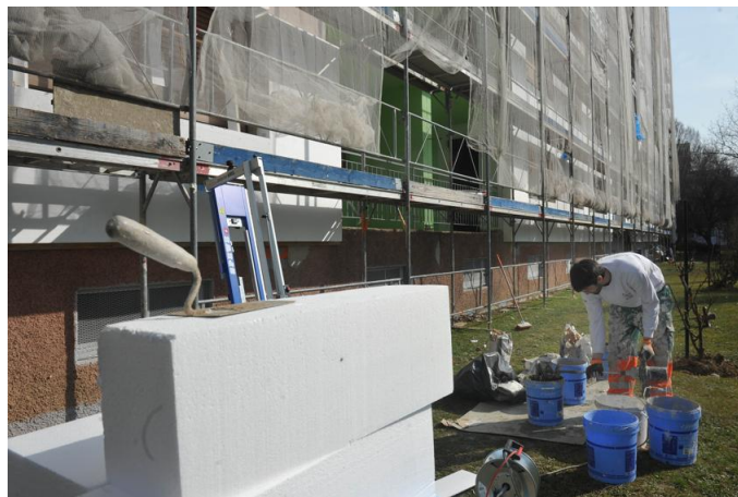
Travaux d'isolation à La Belle Demeure, rue de l'Engelbreit à Strasbourg. PHOTO DNA - MARC ROLLMANN
